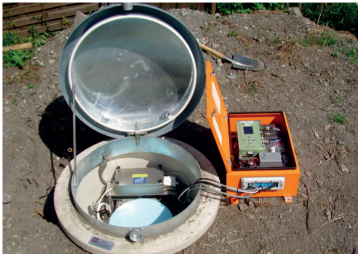
Installazione in campo libero con coperchio aperto
